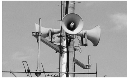
区役所庁本舎の防災行政無線
